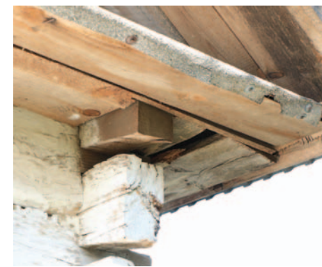
Fot. 19. Podsufitka na narożu domu Podwalina ułożona na ziemi, Wyryki
